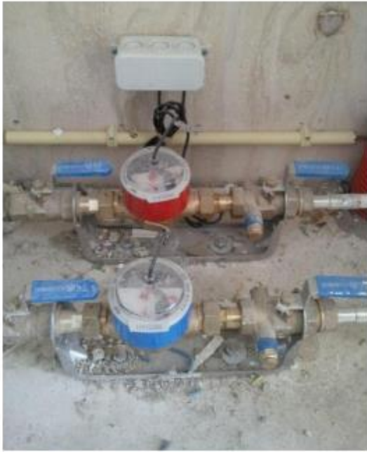
De meterkast met de watermeters voor Warm tapwater (rood) en koud water (blauw)
