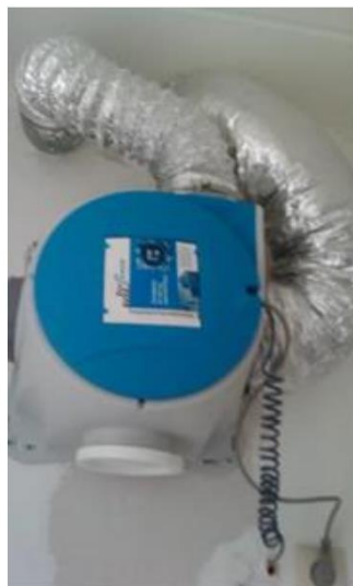
Mechanische ventilatie box in bergkast
