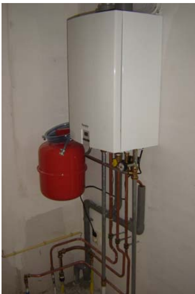
HR-combiketel. Het rode vat is een expansievat.
